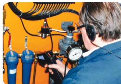
圧力/真空の漏れ
